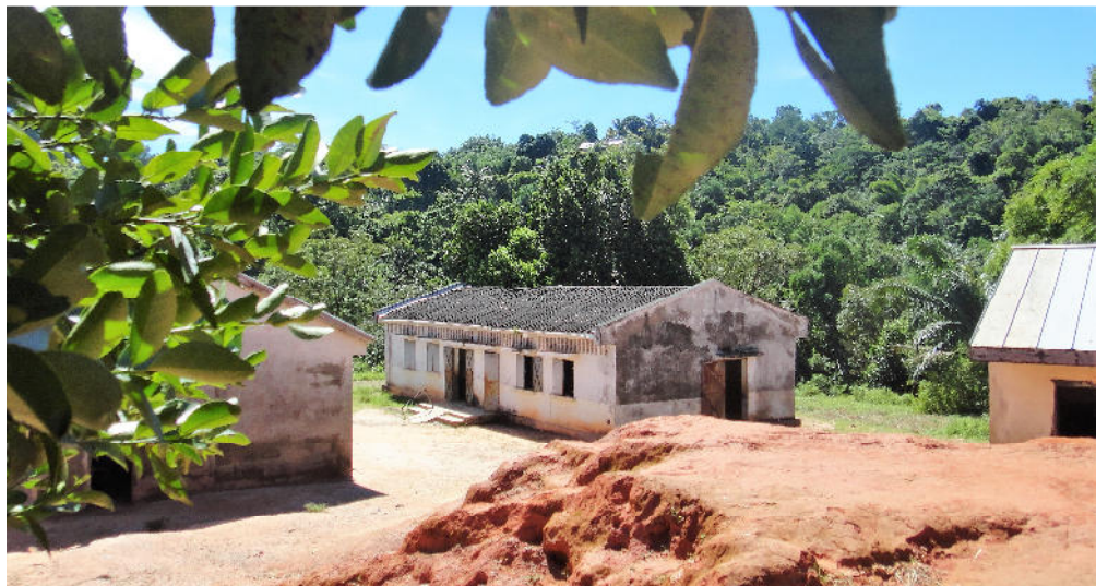
Foto Nr. 5: Das Schulgebäude mit dem zerstörten Dach
